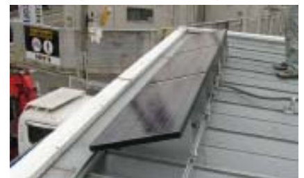
太陽光パネル (屋根に設置)
